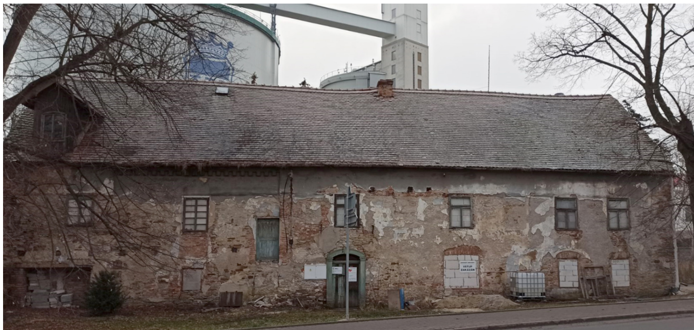
Celkový pohled před opravou střechy
